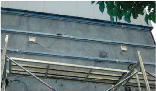
图 3 保温墙体外观及相对湿度和墙面温度探头
